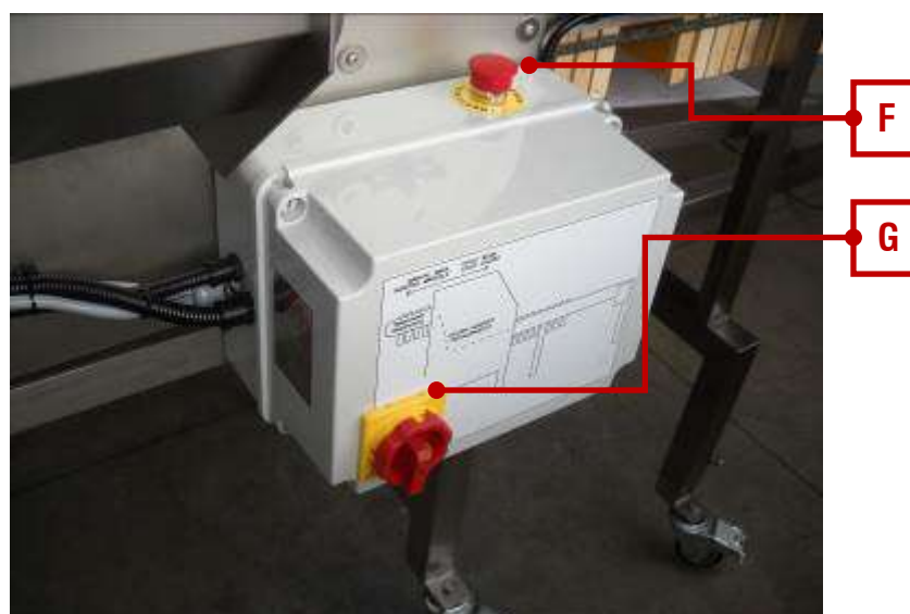
FIG. 2 - tableau électrique générale
