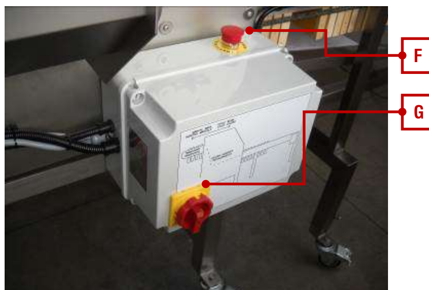
FIG. 2 - Quadro elettrico generale
